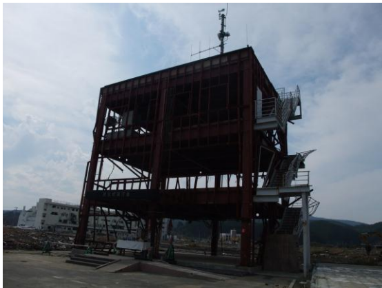
取り壊されることが決まった南三陸町防災庁舎
